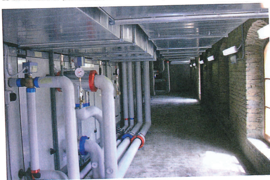
10 Locale tecnico per l'impianto di climatizzazione.
